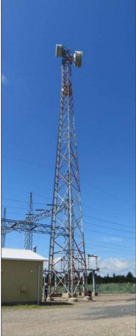
Photo 1 : Tour autoportante en acier de 30,48 mètres avec deux micro-ondes et bâtiment de commande
